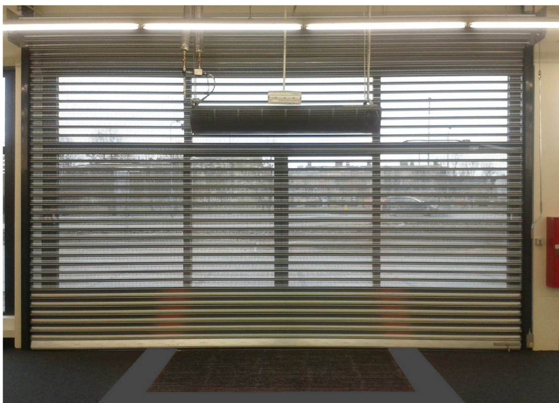
Przykład kraty rolowanej – na wejściu głównym
